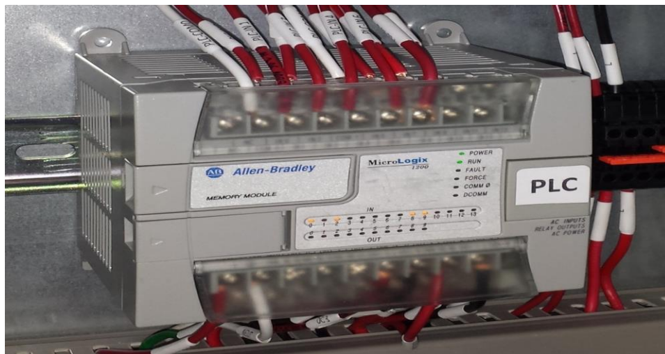
Figura 1.- Controlador Lógico Programable (PLC) Allen Bradley [1].
